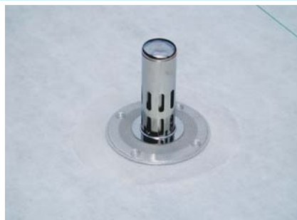
脱気筒の設置(脱気筒下の通気緩衝シートを繰り抜きしビス留め50~70mmに1ヶ所水上に設置)
