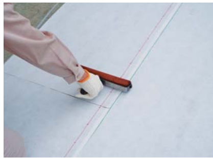
FPシートの転圧 (転圧ローラーにて転圧する) ※転圧不足は、しわ・剥離・膨れ・クラックの原因
